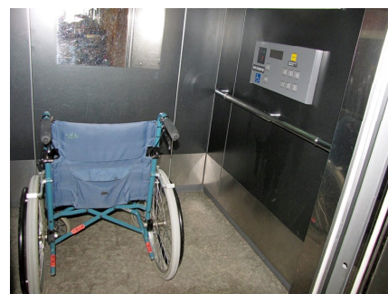
車椅子対応エレベーター
